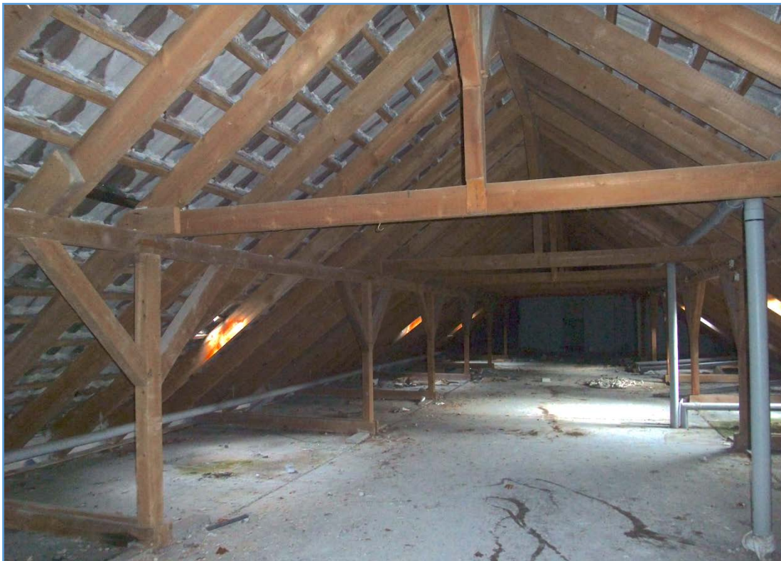
Abb. 10: Dachboden Hauptgebäude: Der Dachboden ist versteckarm und auf Grund von Bauschäden zugig.
