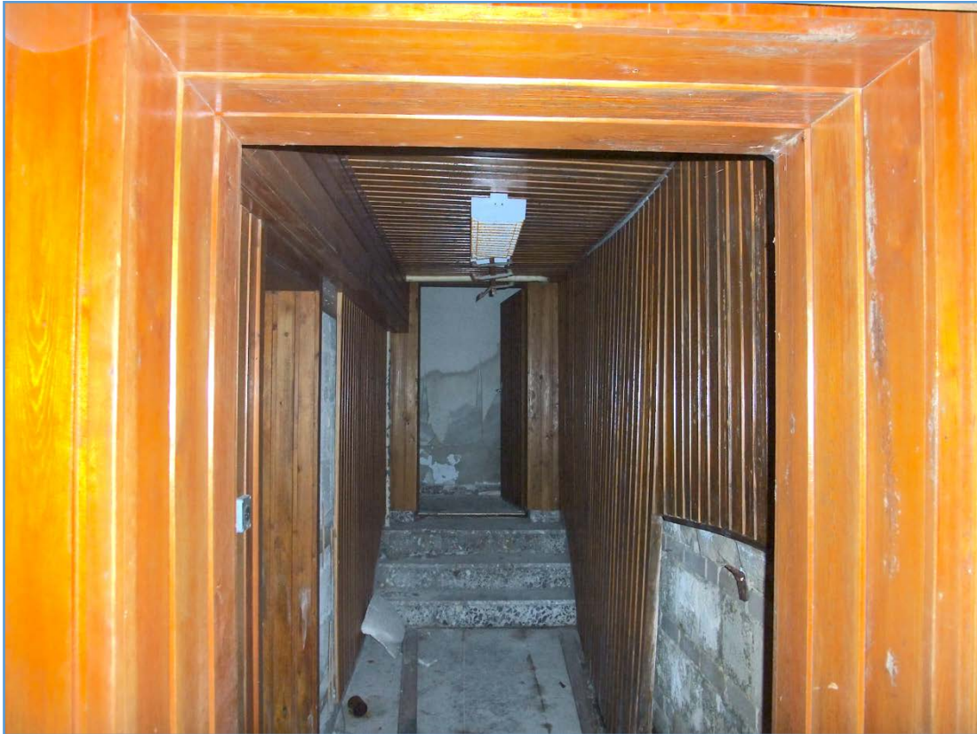
Abb. 7: Viele Stellen des Kellers im Hauptgebäude sind für Fledermäuse nicht nutzbar.
