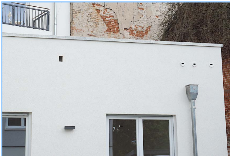
Abb. 58: Integration von einem Mauersegler- kasten 17A, dreifach und einer Halbhöhle 1HE für Hausrotschwänze in einen Neubau. Tino-Schwierzina- Str. 5 in Berlin-Heinersdorf, 2021.
