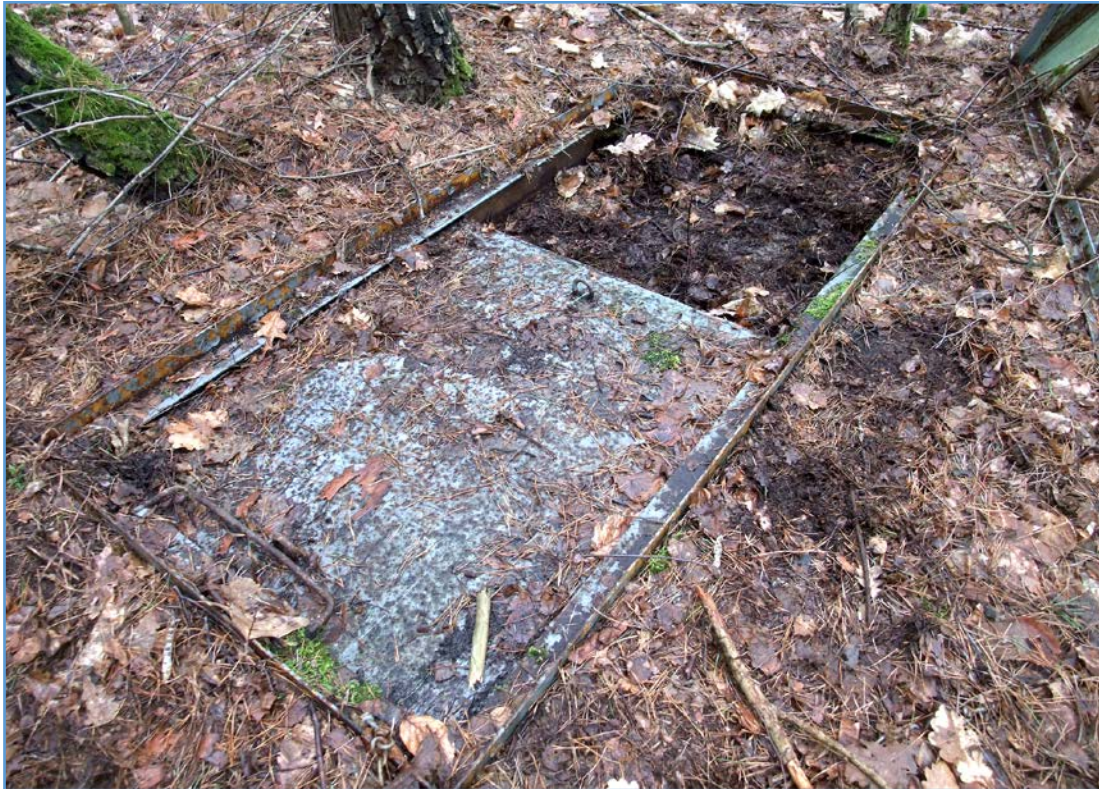
Abb. 3: Bauteil 7, Übergabestation / Notstromaggregate: Das unterirdische Bauteil wurde geöffnet und kontrolliert. Es ist für die Überwinterung von Fledermäusen ungeeignet.
