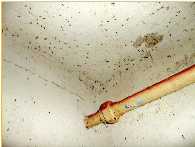
Abb. 50: Mücken im Keller unter der Kegelbahn sind ein Zeichen für Frostfreiheit und hohe Luftfeuchte. Der Keller ist klimatisch als Fledermauswinterquartiere geeignet. Eine Optimierung ist Erfolg versprechend.
